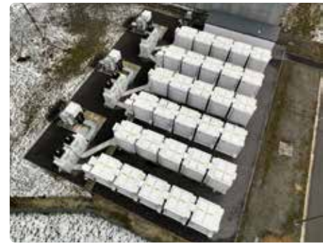
GreenStor • ESTOR-LUX batterijpark, Bastogne
