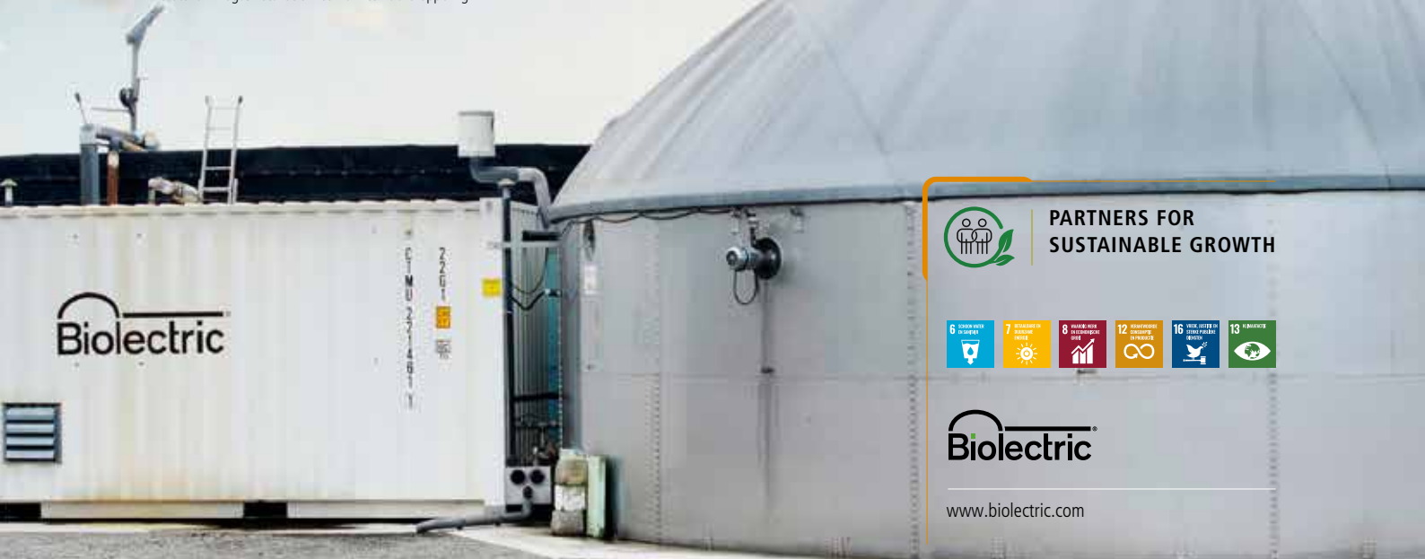
Bioelectric • Biogasinstallatie met warmtekrachtkoppeling
